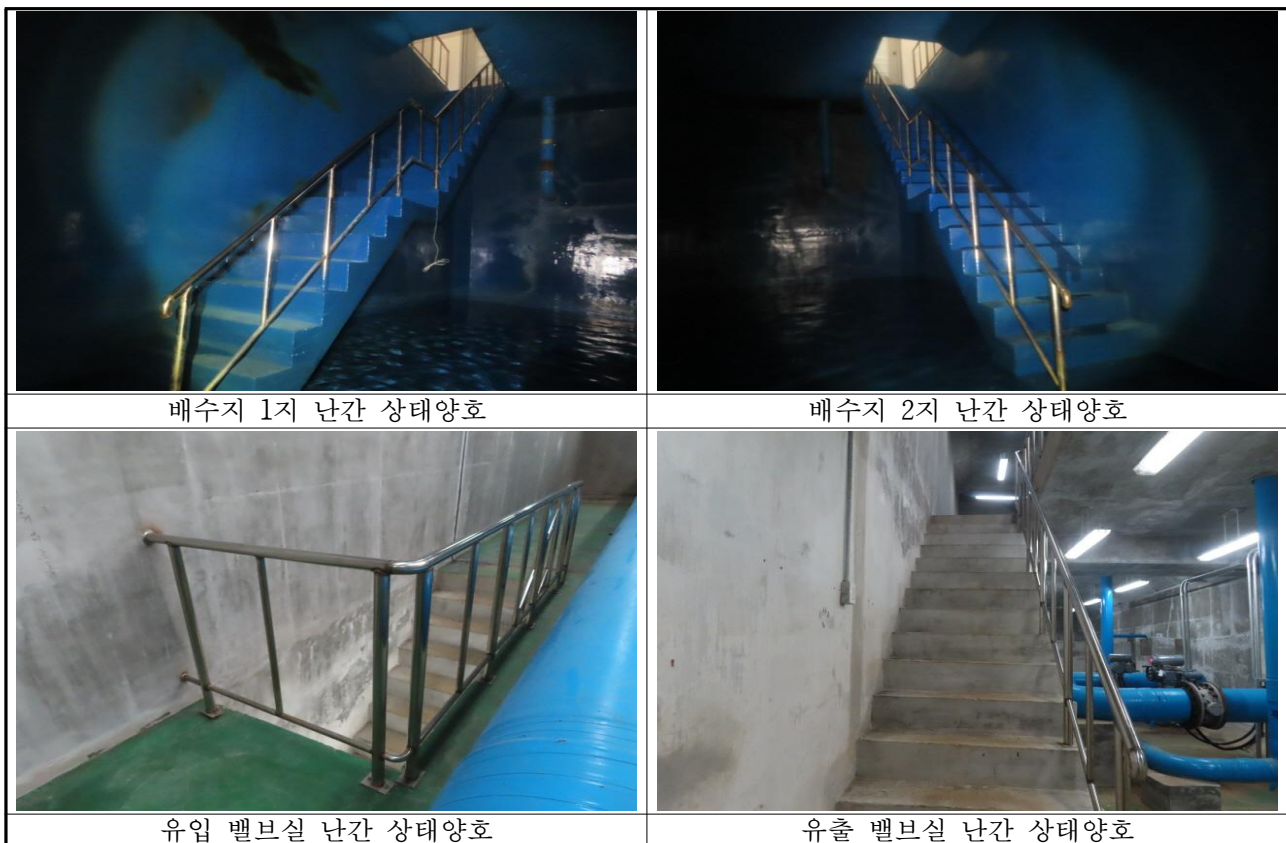
【사진 3.7】 안전시설(점검로) 손상사진
