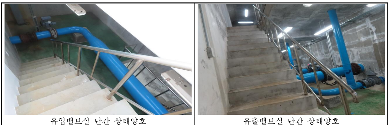
【사진 3.9】 추락방지시설 손상사진
